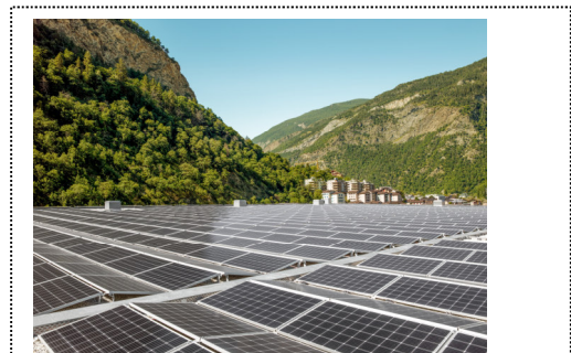
Photovoltaikanlage auf der Lonza-Arena in Visp (Bild: Energiedienst / Daniel Infanger)
