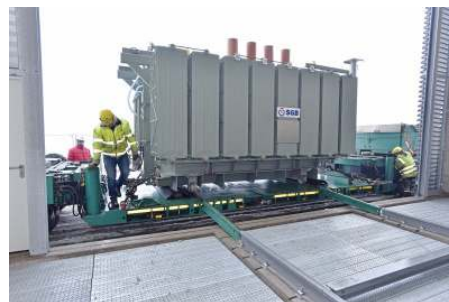
Neues Umspannwerk ED Netze GmbH in Löffingen (Bild: Energiedienst / Roland Sigwart)
