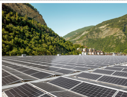
Photovoltaikanlage auf der Lonza-Arena in Visp (Bild: Energiedienst / Daniel Infanger)
