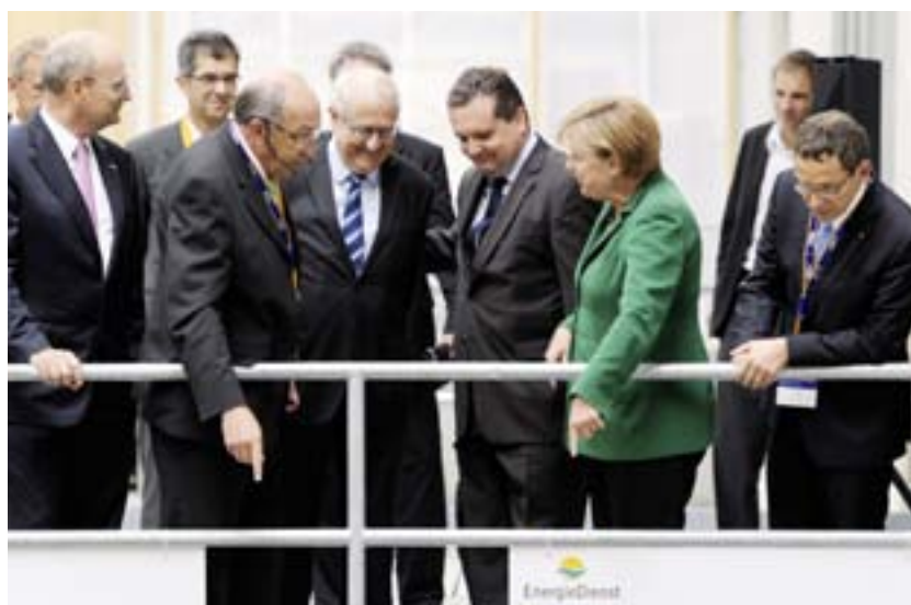
Projektleiter Helmut Reif (4. v. l.) erklärt Bundeskanzlerin Angela Merkel die Funktionsweise einer Rohr-Turbine im Maschinenhaus des neuen Kraftwerks. Auch Wirtschaftsminister Rainer Brüderle (5. v. l.) und Ministerpräsident Stefan Mappus (6. v. l.) sind vom Wirkungsgrad von 94 Prozent begeistert.
