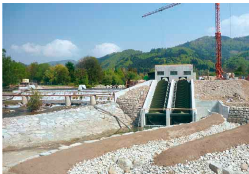
Blick auf die Wasserkraftschnecken und das noch im Bau befindliche Maschinenhaus mit dem Einstieg zum Fischpass.
